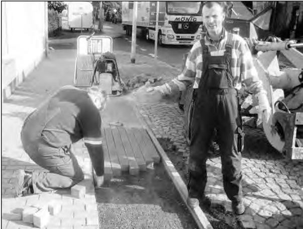
An der Mühlhäuser Straße wird durch die Mitarbeiter des Bauhofes ein Radweg errichtet.
